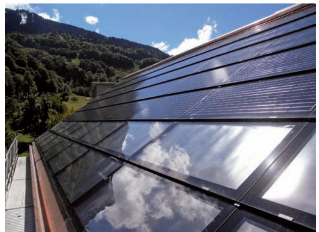
Thermische Kollektoren und Photovoltaik-Module in die Dachhaut integriert. Optisch ansprechend, dabei mit geringeren Wärmeverlusten.
