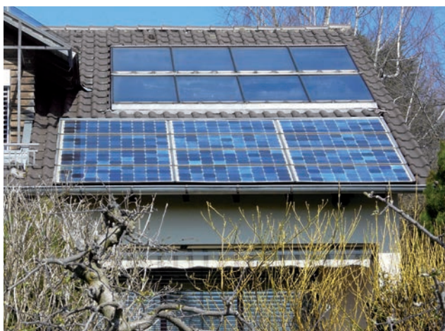
Solaranlagen sind nicht aufeinander abgestimmt.
